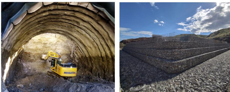
Scavi e formazione dei rilevati della SS106 Jonica – località Palizzi Marina (RC) - Cantiere Jonicastrade s.c.r.l.
